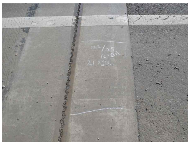
후타재 균열 - 2021년
